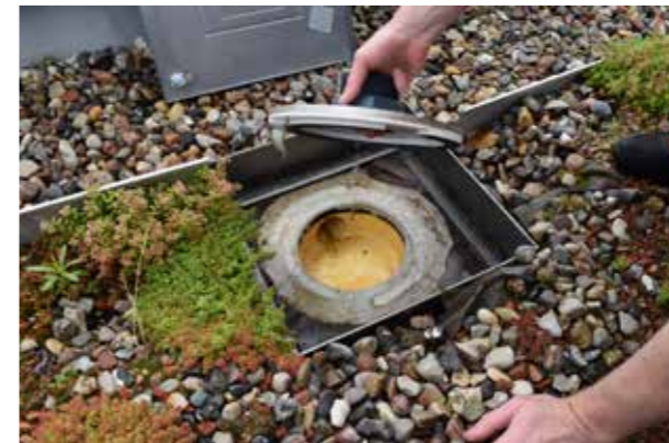
Abb. 48: Die Hafen City Universität Hamburg hat Langzeituntersuchungen zu Retentions Gründächern „Am Weißenberge“ durchgeführt. Quelle: BuGG
