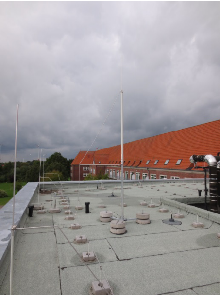
Bild 5: Fangmast auf Flachdach (Quelle: Gepla mbH & Co. KG)
