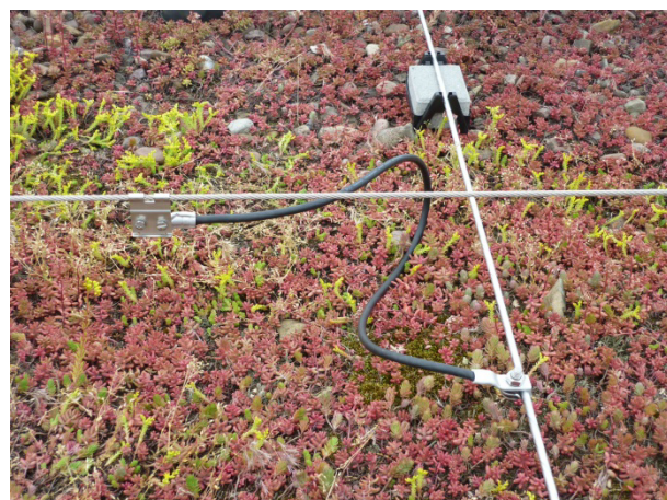
Bild 13: Fangeinrichtung auf einem begrünten Dach (Quelle: Klaus Neumann GmbH)
