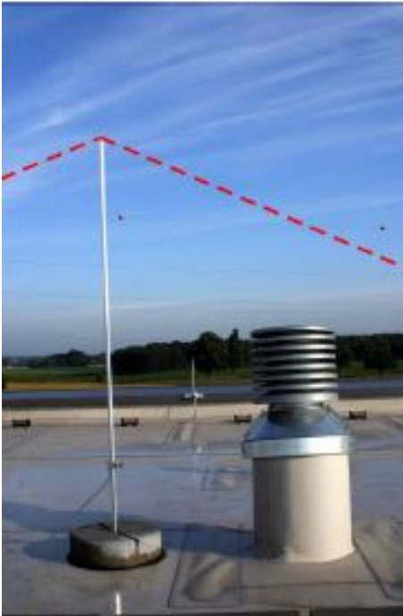
Bild 3: Fangstange auf einem Flachdach (Quelle: VDB-Schulungsunterlage Blitzschutzfachkraft)
