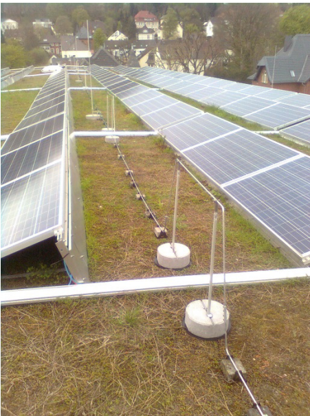
Bild 12: Fangeinrichtung auf einem begrünten Dach (Quelle: Fritz Mauermann Blitzableiter- und Elektrobau GmbH & Co. KG)
