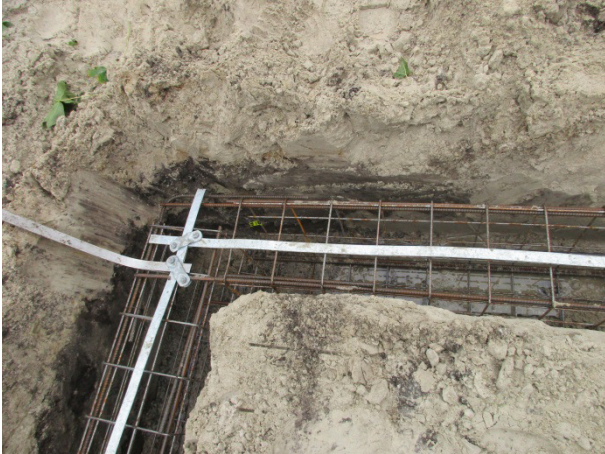
Bild 8: Fundamenterder mit Anschlussfahne (Quelle: Gepla mbH & Co. KG)
