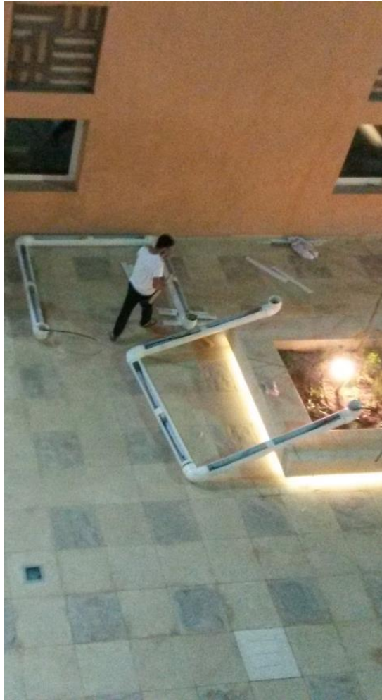
PVC-Rohre als Pflanzenträger mit Drainage und Tröpfchenbewässerung
