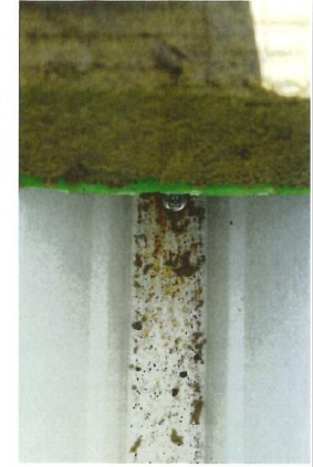
Eindeutig sichtbar: die Wasserspuren im Untergurt
