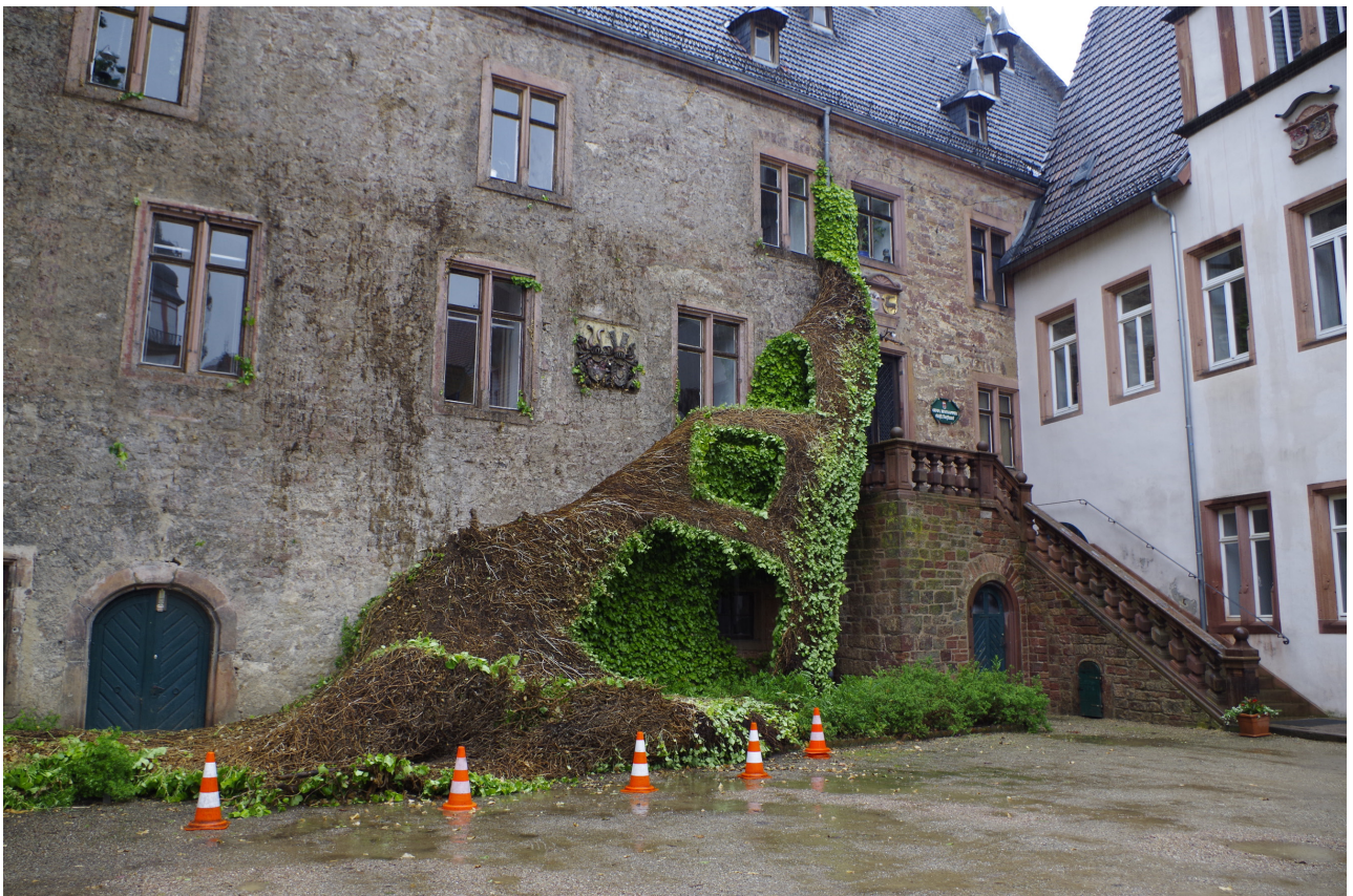
Abb.: unten: Bodengebundene Fassadenbegrünung (Schlosshof Erbach i. Odenwald, 2013): Abriss des gepflegten Efeu- Bewuchses durch Belastung nach Starkregen. Eine Gewichtsentlas- tung der Direktbegrünung durch Verankerung ins Mauerwerk hätte den Schaden vermeiden können. (Foto: Jörg Dettmar 2013)
